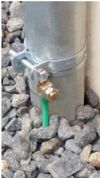
Foto ilustrativa 02 dos anexos W, Y, AA, BB, CC, DD e EE – Detalhe da abraçadeira de com terminal para aterramento
